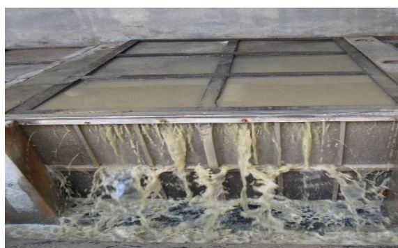
1-2 b 运行中的自流式滤粪柜
